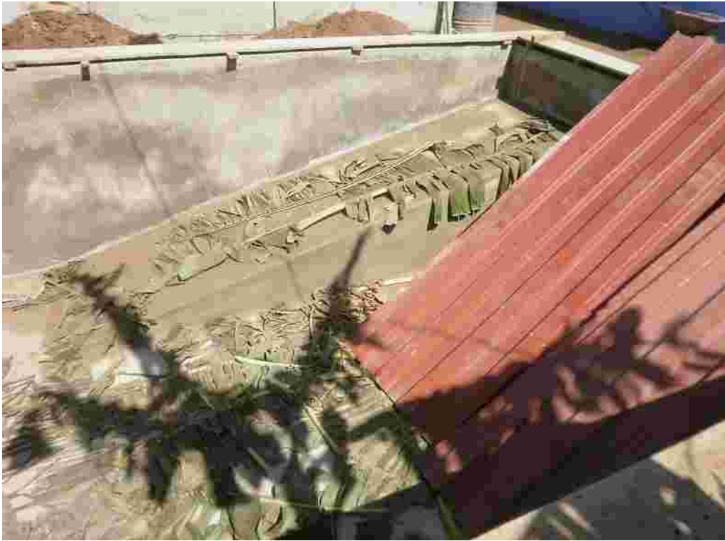
Schwimmbecken mit Rampe. Hier noch mit Bananenblättern zugedeckt, um den Beton vor der heißen Sonne zu schützen.
